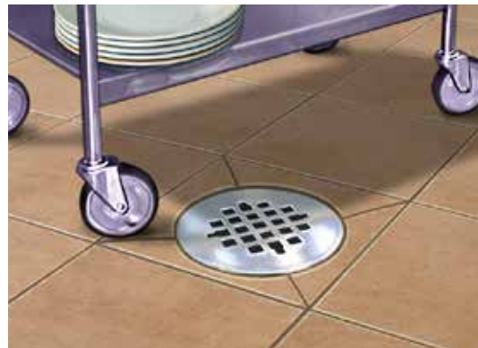
污水排水孔：流向污水處理廠的室內排水孔。
